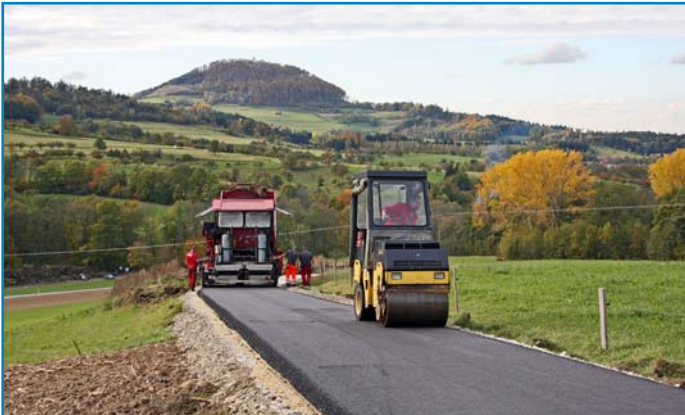
Die Gemeindeverbindungsstraße vom Saurenhof bei Waldstetten in Richtung Hornberg erhielt auf einem Teilstück von 400 m eine neue Asphaltdecke und die Straße wurde auf eine Breite von 3 m ausgebaut. In dieses Straßenstück investierte die Gemeinde 45.000 €.
