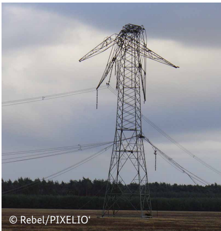
Sturmschaden durch den Orkan Kyrill im Jahr 2007
