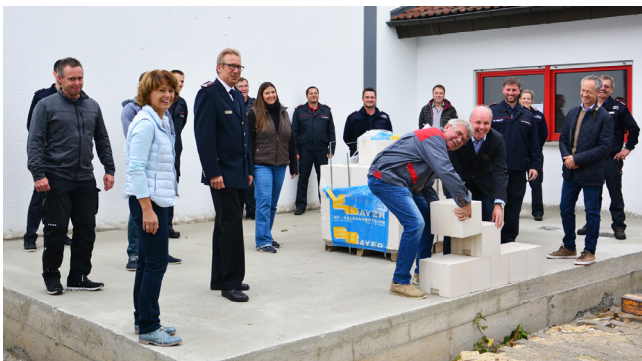
Martin Mager von gleichnamigen Waldstetter Bauunternehmen sowie Schultes Michael Rembold legen symbolisch den Grundstein für den Anbau des Wißgoldinger Feuerwehrhauses im Beisein aller am Bau Beteiligten sowie Ortsvorsteherin Monika Schneider (links vorne) und Gesamtkommandant Ingo Brosch (vorne Zweiter von links).
