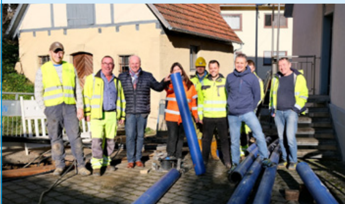
Der Bau der neuen Versorgungsleitung ist im Zeitplan. Noch vor dem Wintereinbruch sollen sämtliche Straßengräben verbaut sein, so die Vertreter der Gemeinde Waldstetten und des Ingenieurbüros Riker+Rebmann aus Murrhardt. (Foto: Benjamin Richter)
