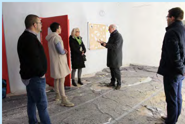
Bei ihrem Besuch erhielt Martina Häusler auch Einblick in die Baustelle an der Gemeinschaftsschule
